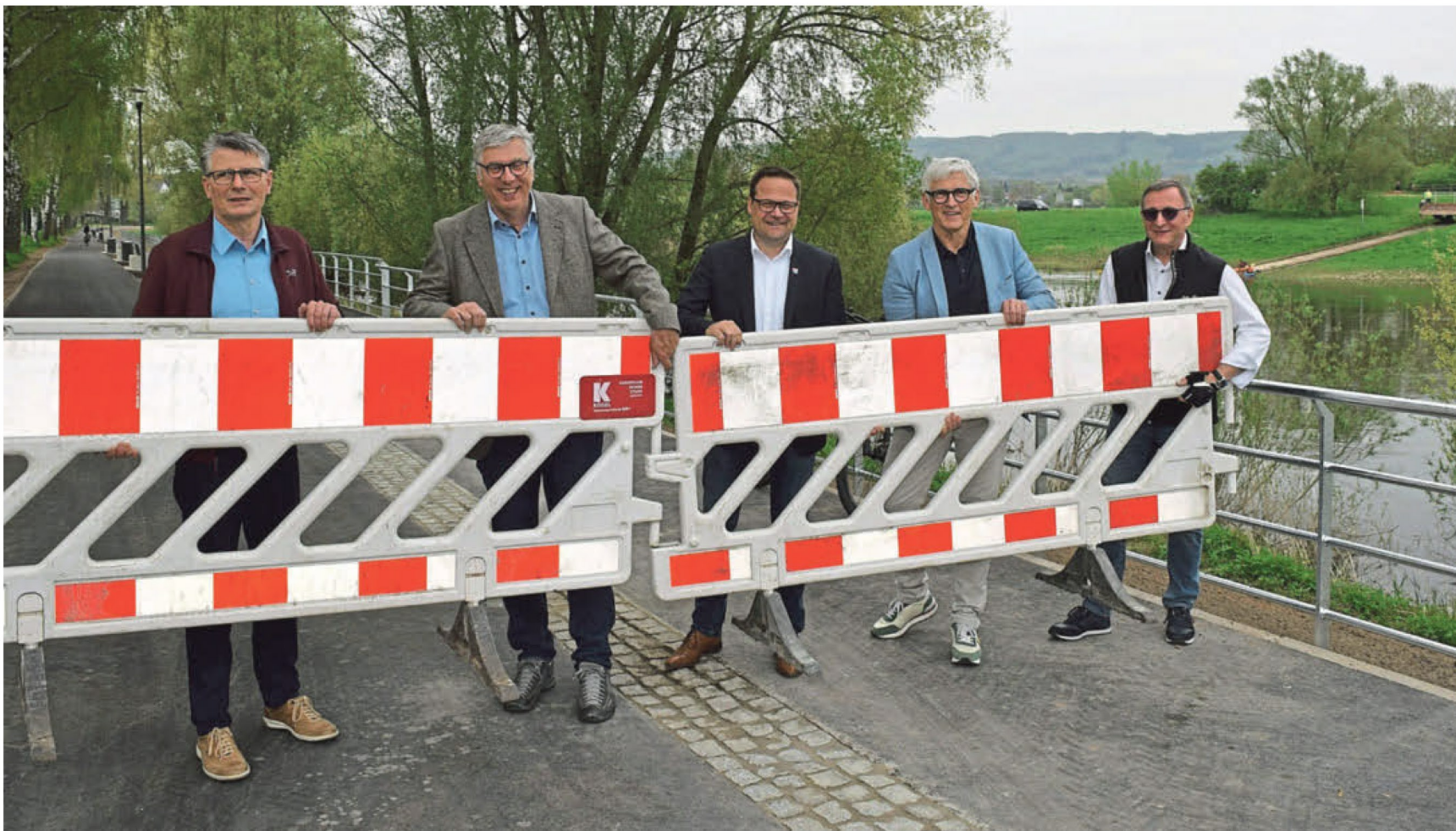
Der erste Bauabschnitt des Radwegs ist fertiggestellt. Der Oeynhausener Beigeordnete Thomas Lüer (von links), Bruno Peters (Peters und Winter, Landschaftsarchitekten aus Bielefeld), Bürgermeister Lars Bökenkröger, Unternehmer Frank Kögel und Kurt Nagel (Vorsitzender des Ausschusses für Stadtentwicklung) räumen die Absperrungen beiseite. Fotos: Andrea Berning
